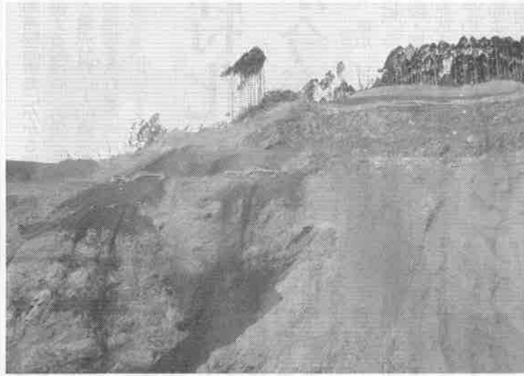
採石区域の拡張を進めており約400mレベルから掘り下げている
