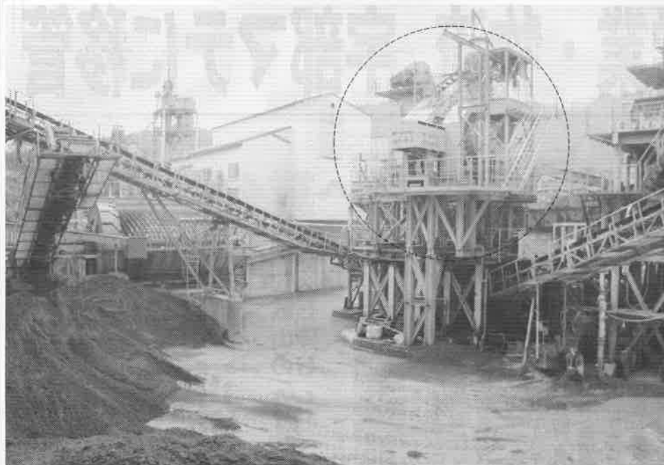
第6工場に新設したボールミルと湿式砕砂「ウェットサンド」(左)
