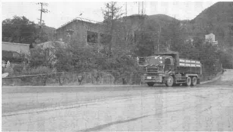
昨年、事務所前など3カ所で「1DAY PAVE」（早期交通開放型コンクリート舗装）を実施した
